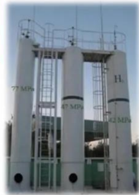
高压储氢设施
