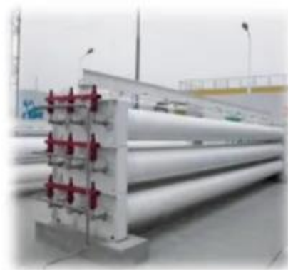
高压储氢设施
